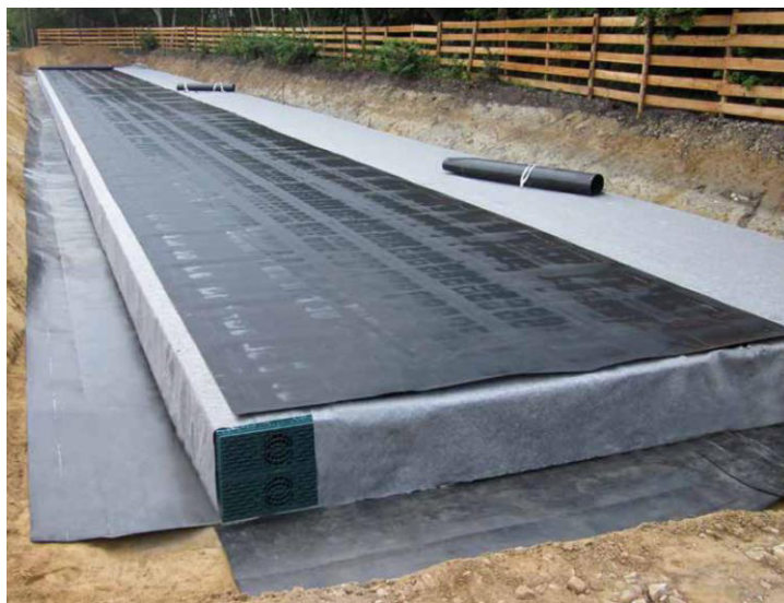
Abbildung 7: Unterirdische Zisterne zur RW-Nutzung (Beispiel RigoCollect, Fränkische)
